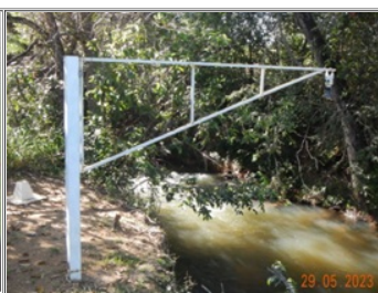
Figura 02. Radar com braço articulado, instalado às margens do rio.
