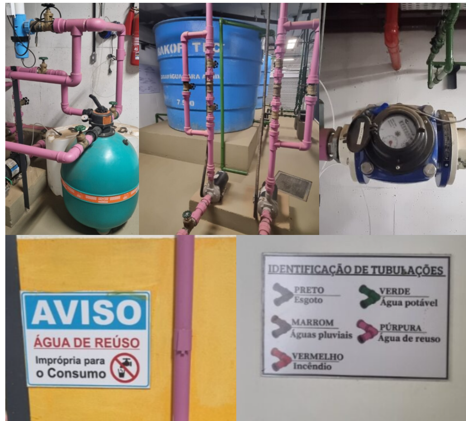
Sistema de tratamento; Reservatório de armazenamento; Hidrômetro; Sinalização de segurança; Identificação.
