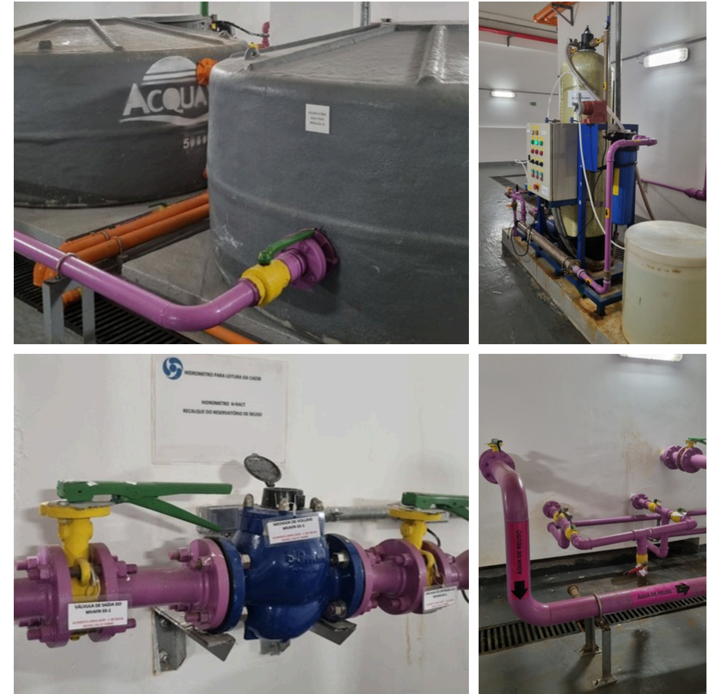
Reservatórios de água pluvial; Sistema de tratamento (automação); Hidrômetro para aferição do consumo; Tubulação água de reúso identificado.
