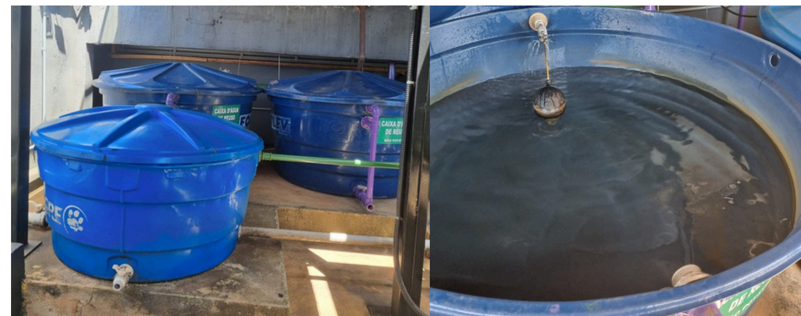
Reservatórios superiores de água da chuva
