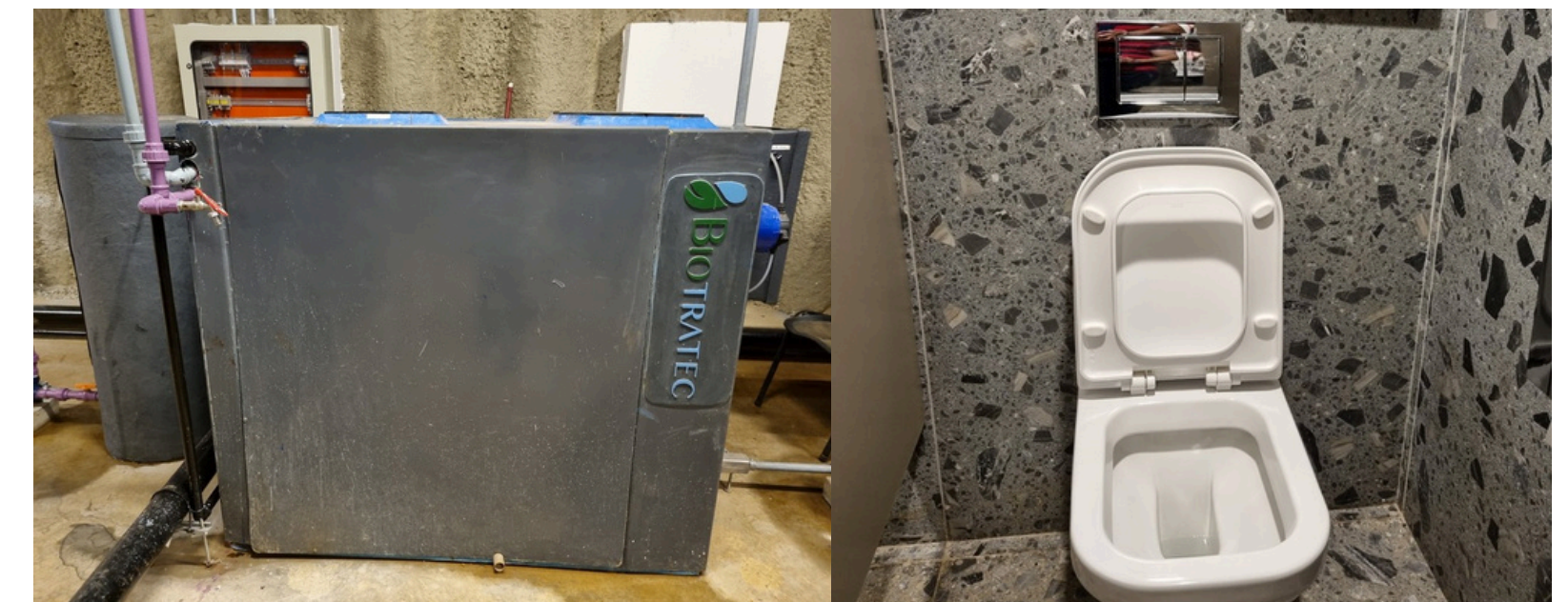
Unidade de tratamento
