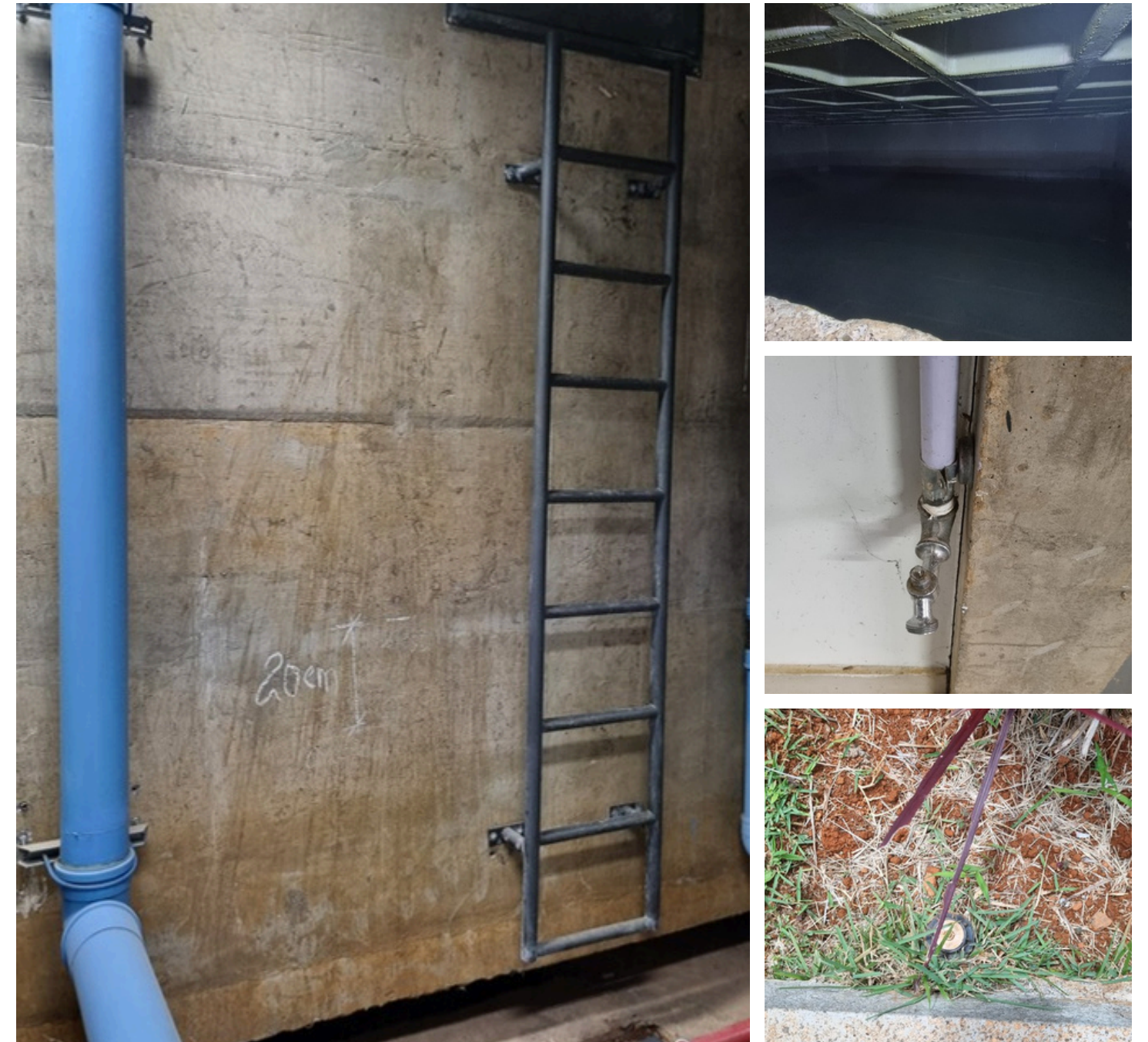
Reservatório da água pluvial; Vista interna do reservatório; Torneira de uso final; Aspersor.
