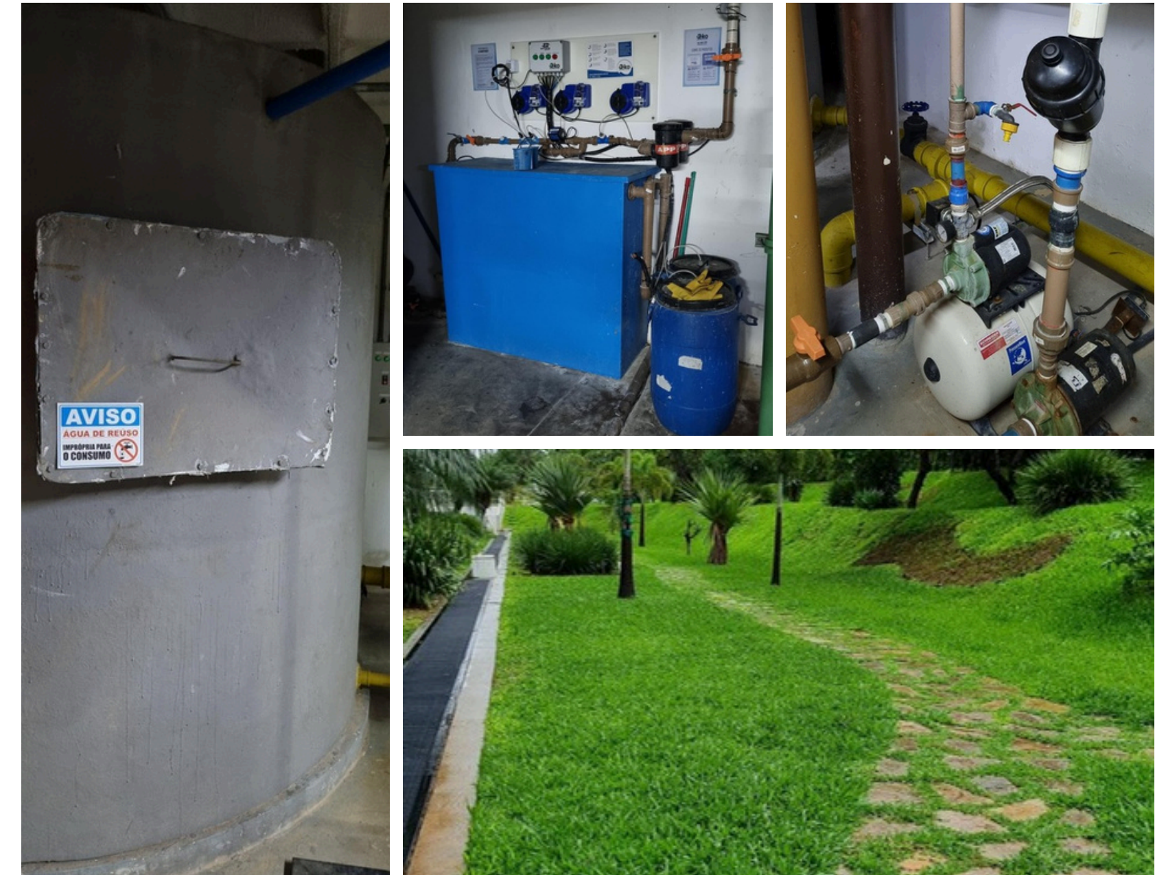
Reservatório de água de reúso; Sistema de tratamento; Detalhe do sistema de bombeamento; Parte da área de uso final.
