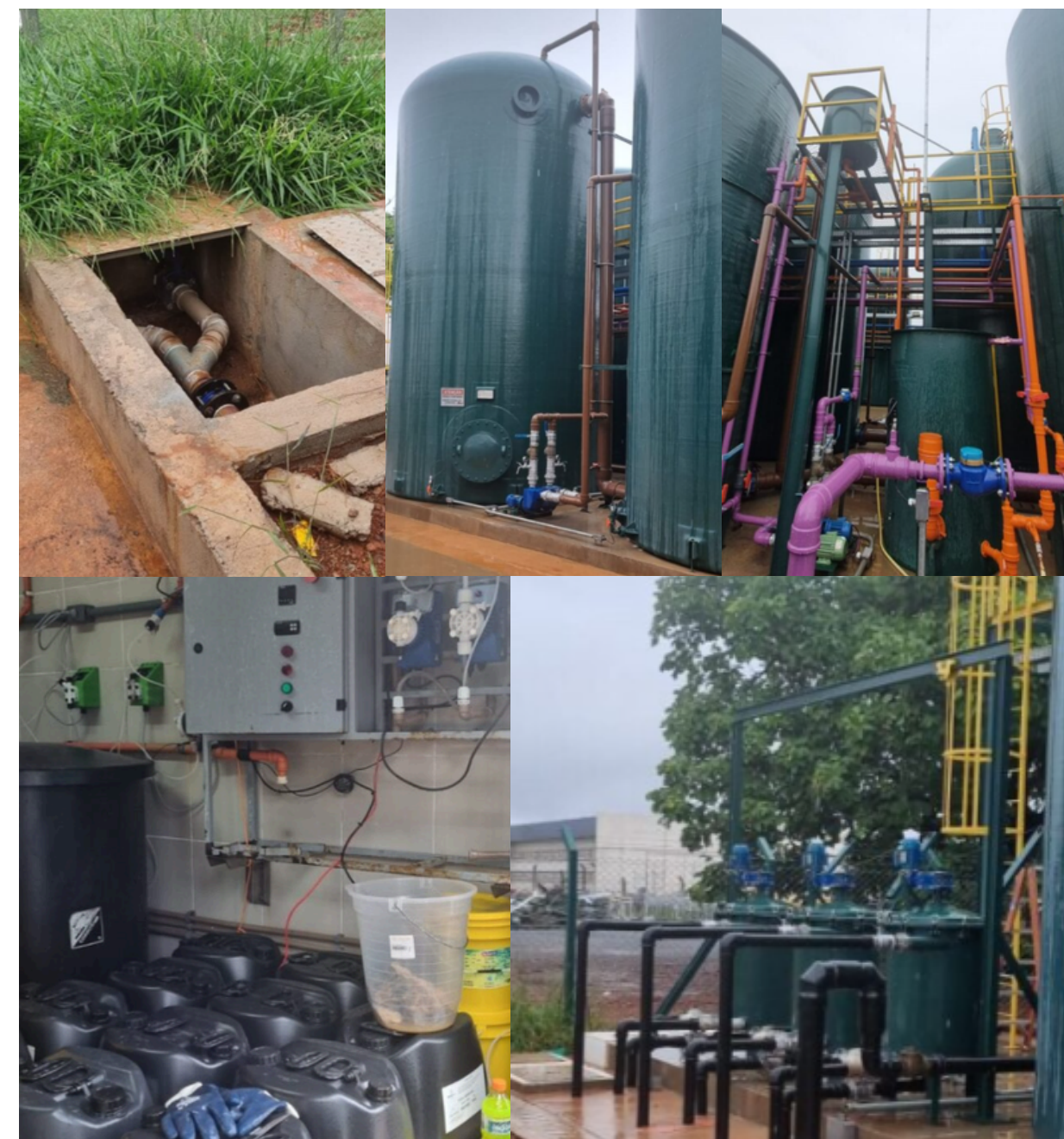
Ponto de captação; Tanque de tratamento; Reatores biológicos e módulos de Ultrafiltração; Sala de controle; Desinfecção.
