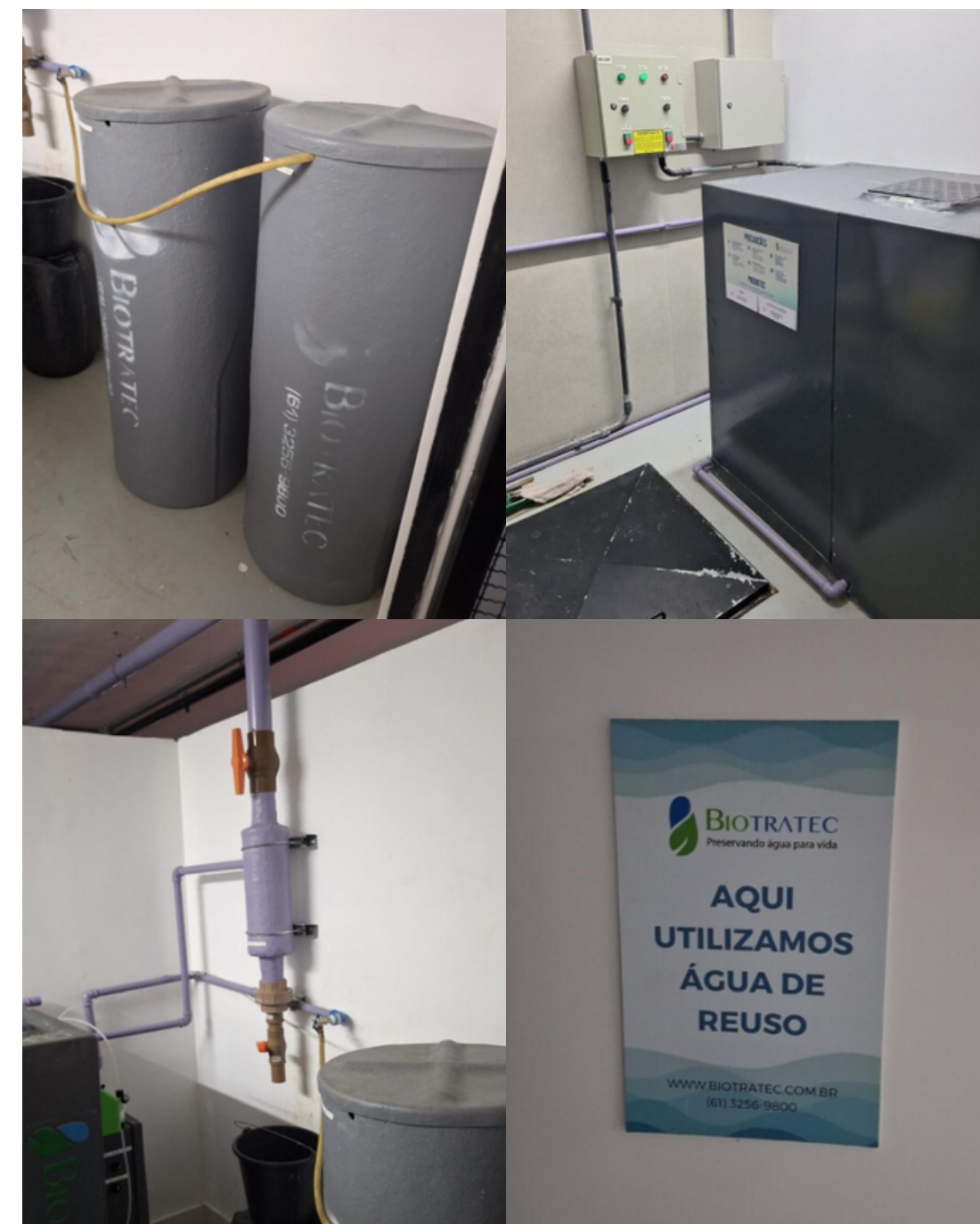
Reservatórios de água de reuso; Estação de tratamento; Tubulação e filtro; Informativo.
