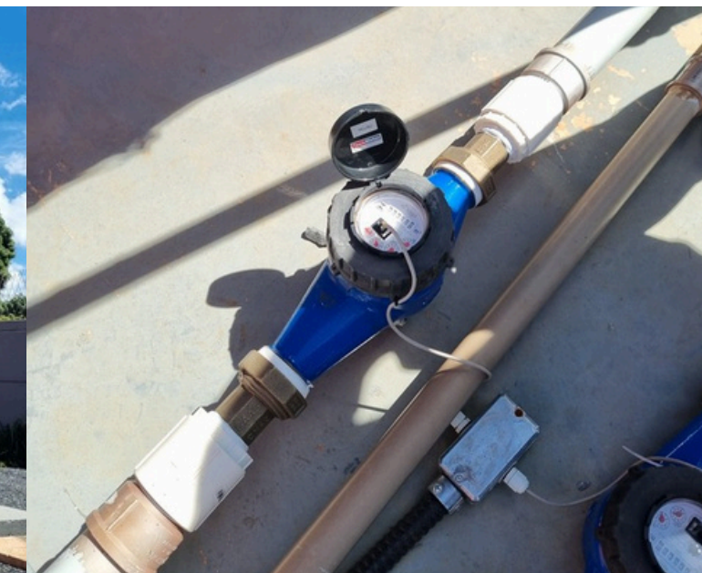
Hidrômetro de água da chuva
