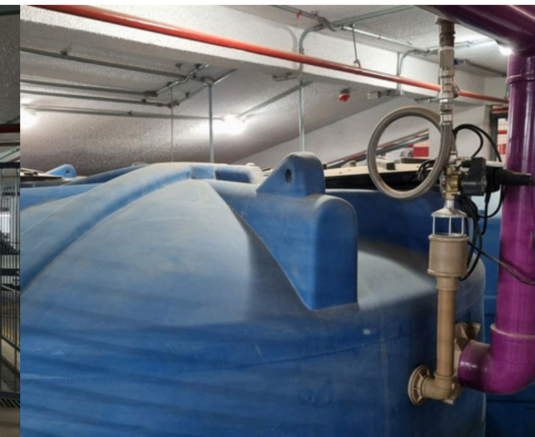
Reservatório com separador atmosférico
