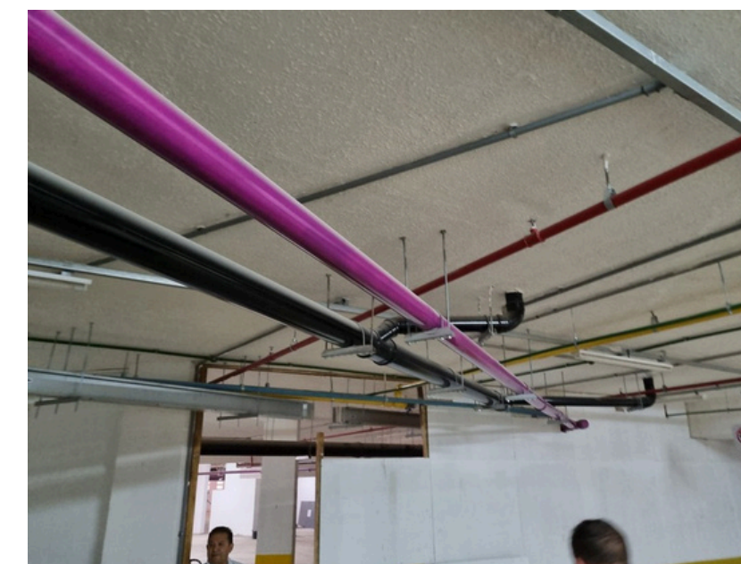
Tubulação de água da chuva
