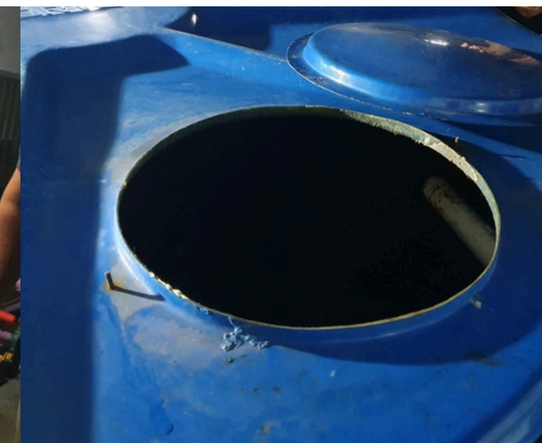
Unidade de tratamento
