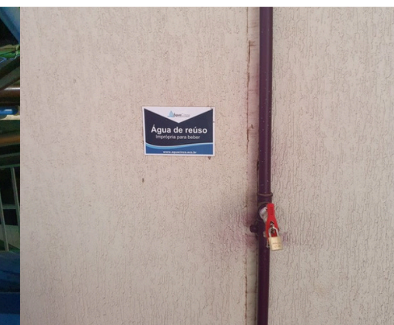
Torneira de uso final sinalizada e com cadeado.
