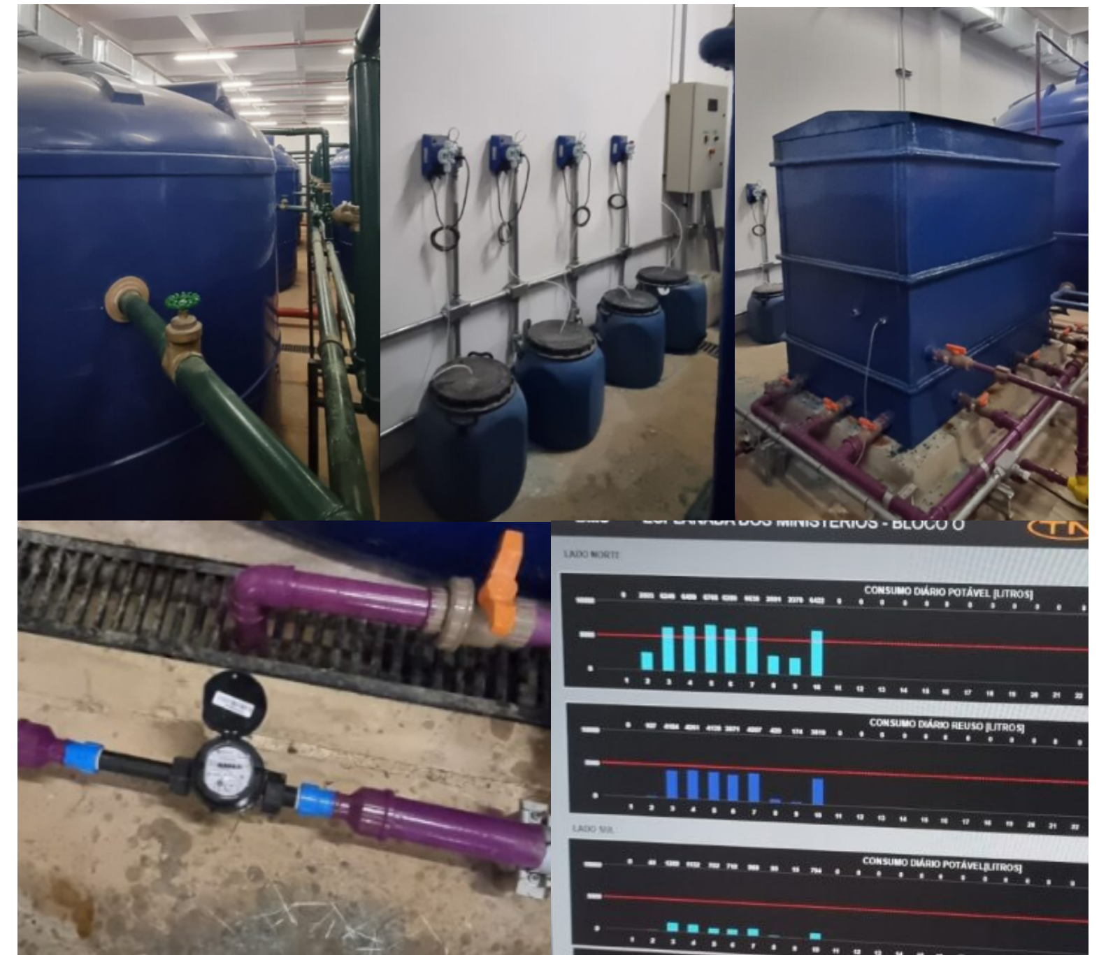
Reservatórios; Tanques de dosagem; Tanque de Coleta; Medidor; Painel de controle.
