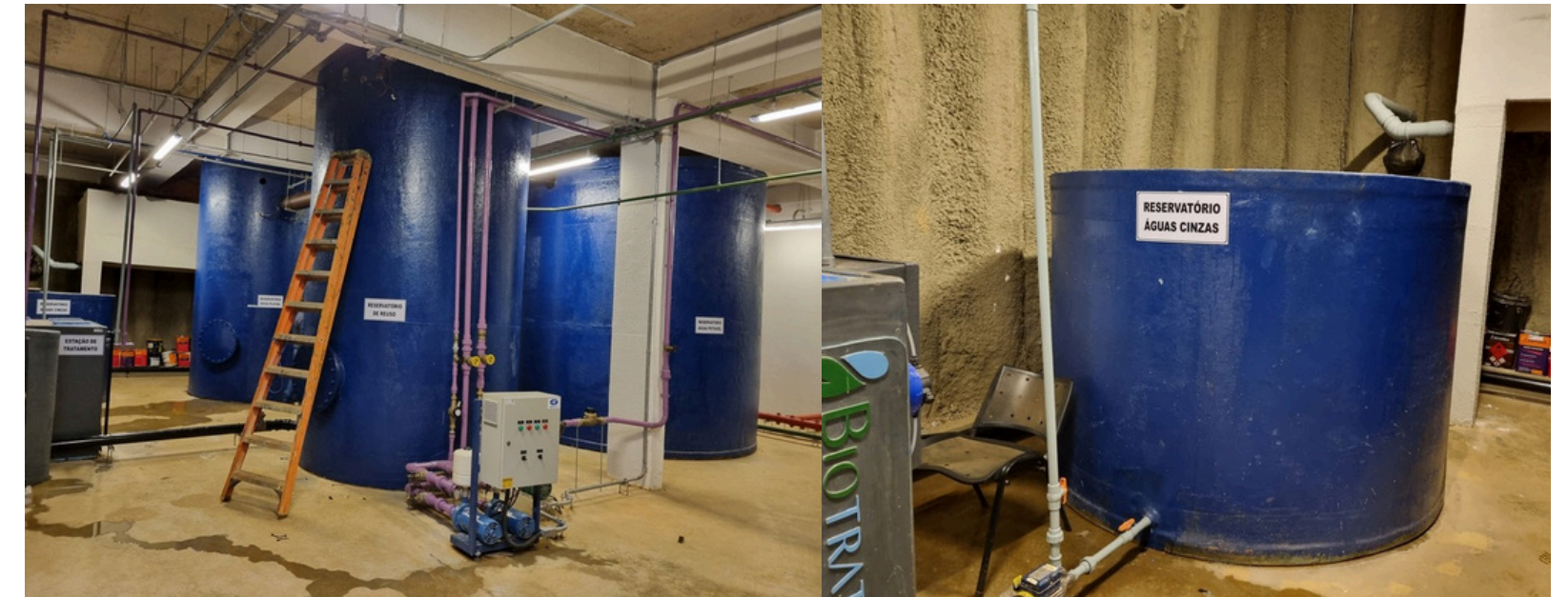
Reservatórios do sistema
