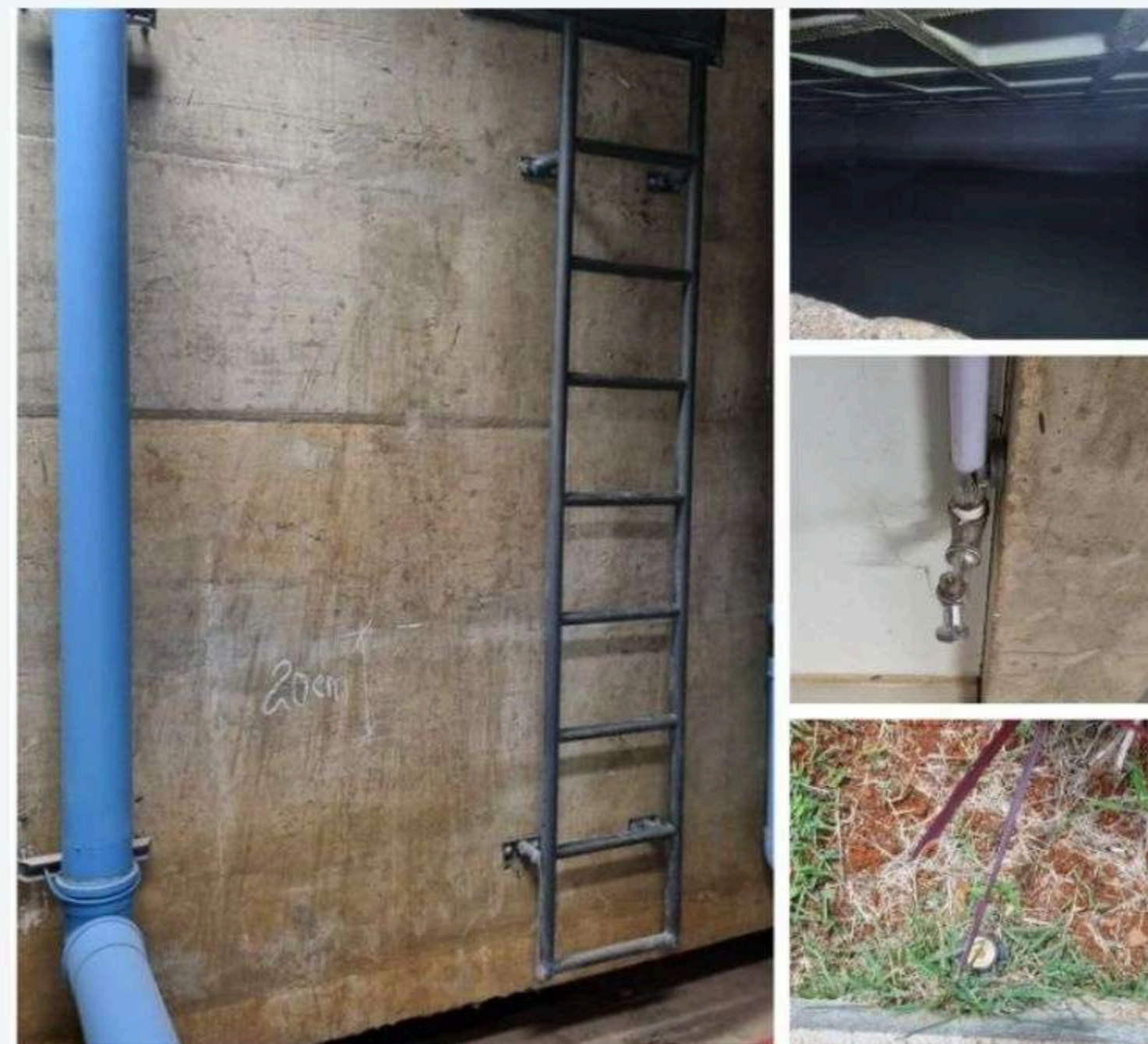
Reservatório da água pluvial; Vista interna do reservatório; Torneira de uso final; Aspersor.
