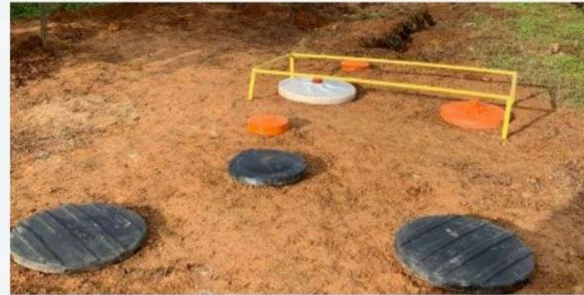
Fossa ecológica instalada
