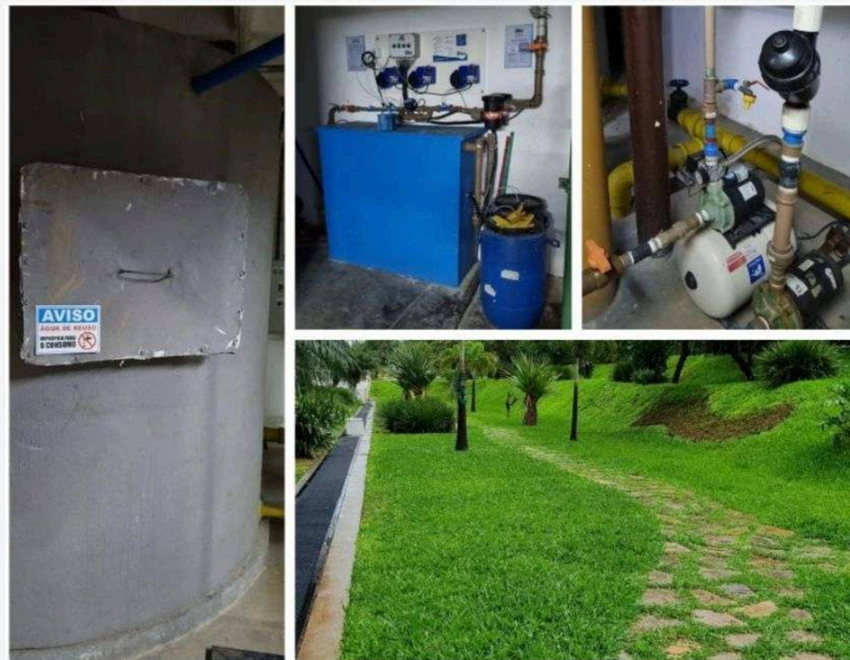
Reservatório de água de reúso; Sistema de tratamento; Detalhe do sistema de bombeamento; Parte da área de uso final.
