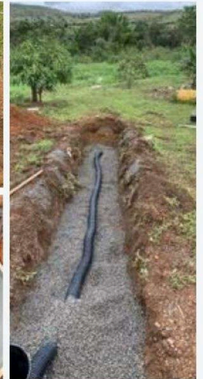
Valas de infiltração da fase líquida
